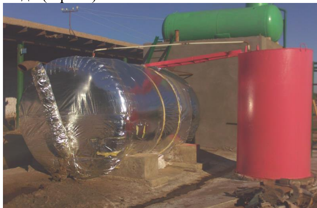
1-расм. «Biogaz-ekologiya energiya va organic o'git» МЧЖ биогаз қурилмаси
