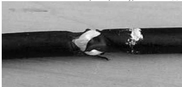
Рис. 6. Разрушение оболочки ОК
