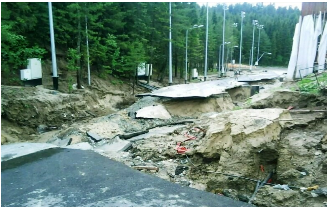
Рис.1. Разрушение полотна биатлонной трассы
