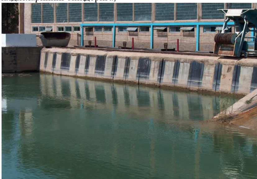
1 – расм Насос станциясидаги аванкамеранинг кўриниши.
