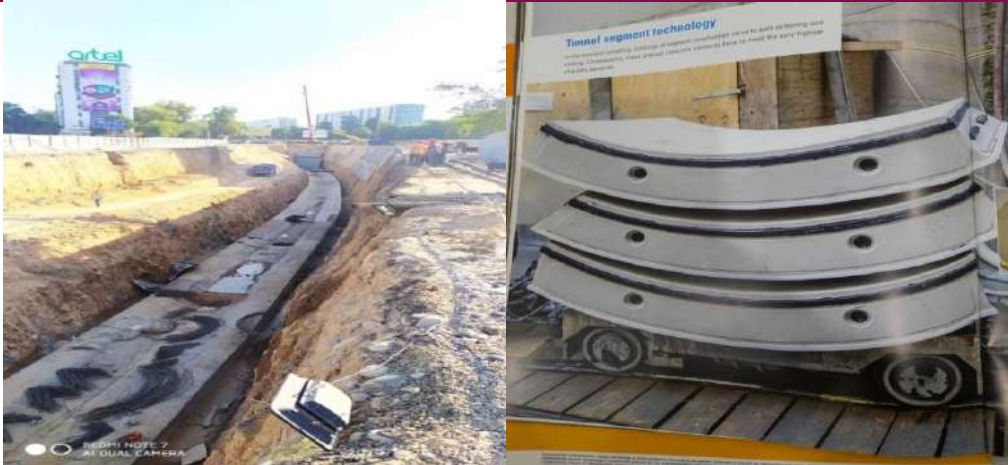
Юнусобод йўли Туркистон метро бекатигача булган ер ости йулининг тубинг темирбетон конструкциялари
